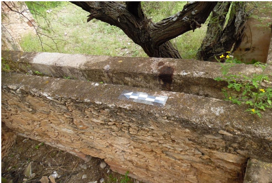
Ilustración 32 Canalización de agua a varias estructuras. Fotografía de Erika Paola Rosales. Octubre de 2018.
