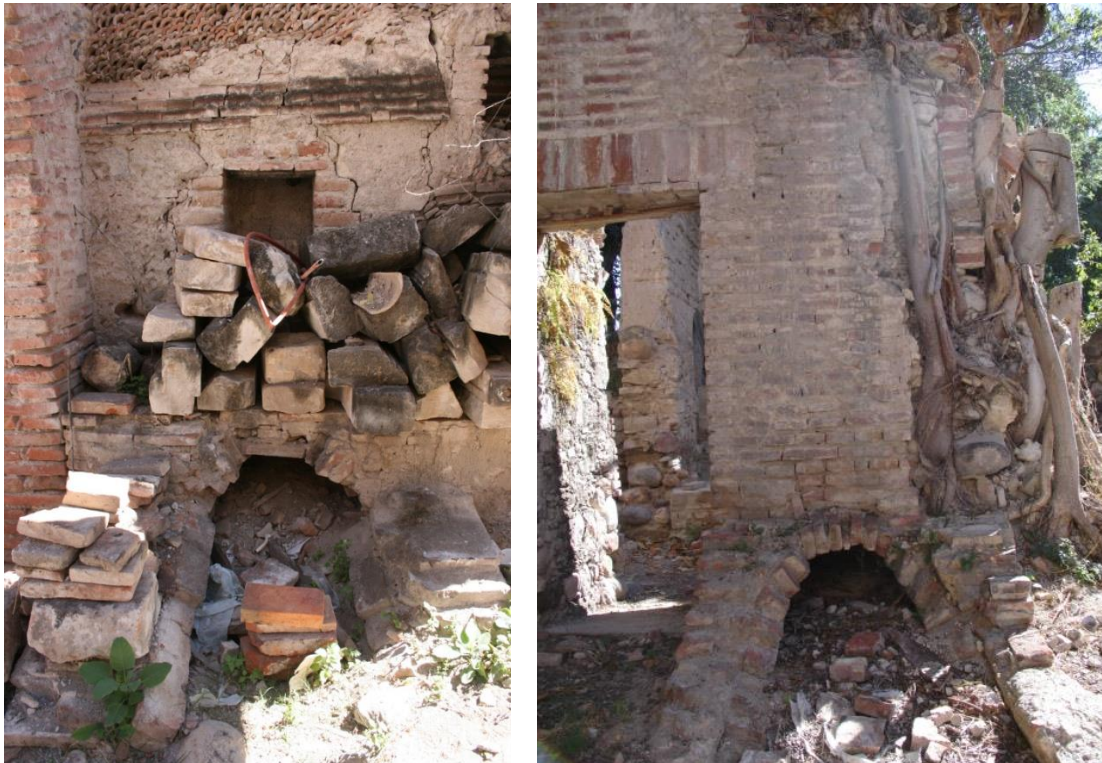
Fotografías 11 y 12: Evaporadores en la casa de calderas de La Mezquitera Norte. FMM.
