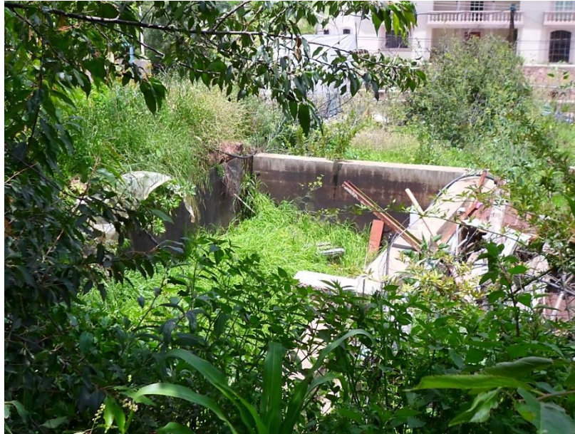
Grafico 102: Vista de una de las pilas para contener y distribuir el agua en la huerta de La Pinta.
