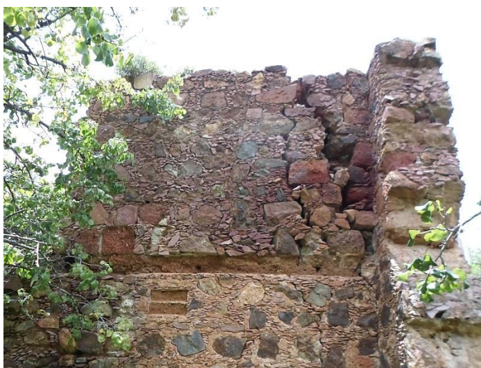
Figura 152: Estructura asociada al beneficio de metales, la cual colapso durante el periodo de excavación por el exceso de humedad provocado por las lluvias.
