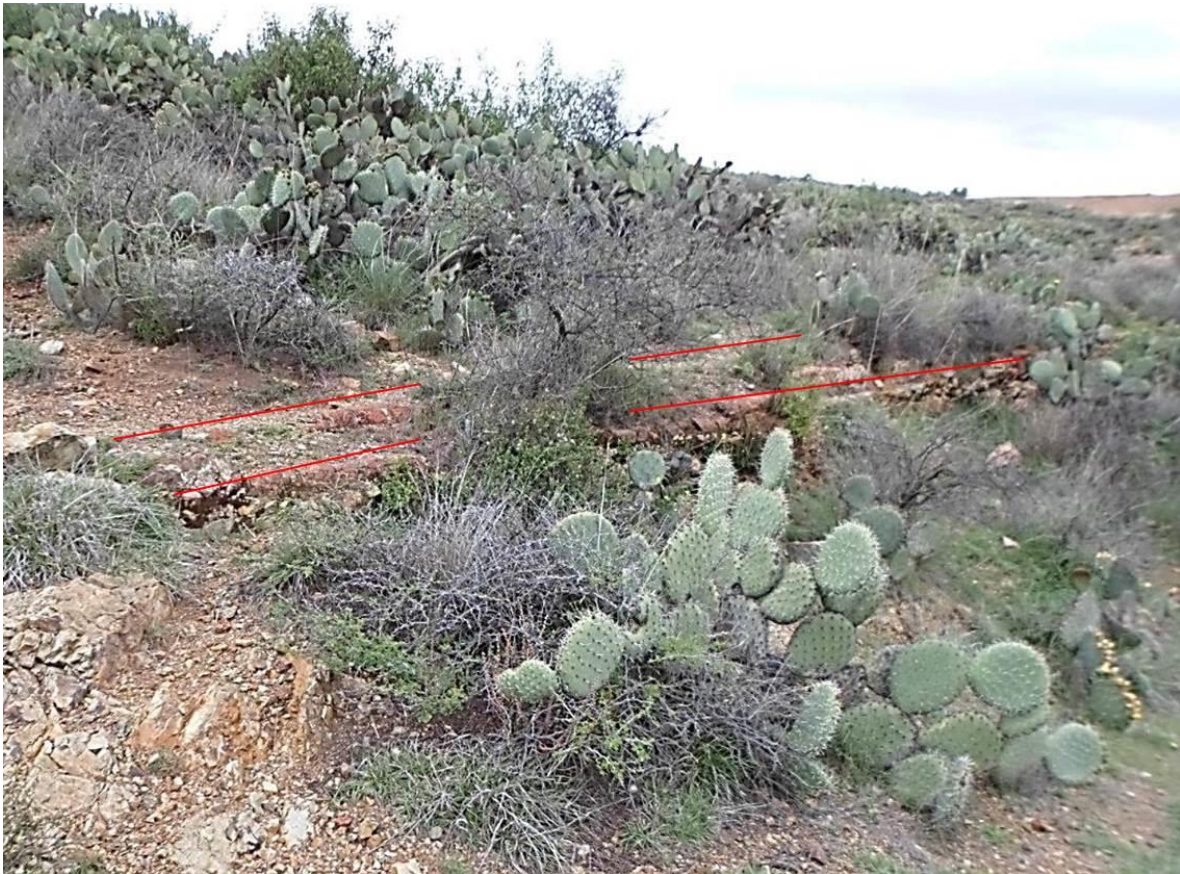
Figura 49: Vista del deterioro de la acequia.
