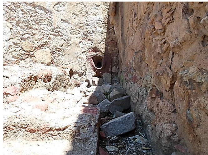
Figura 58: Detalle de tuberías interiores
