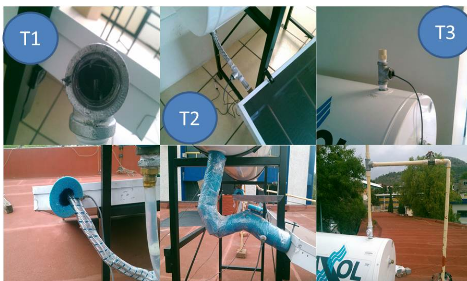
Figura 3.17 Adaptación de los sensores DS18B20.
