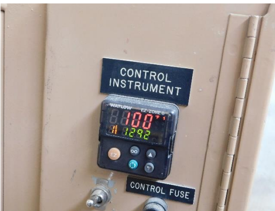
Figura 4.14 Configuración de temperatura en horno eléctrico de inducción por 30 min a 600 °C para precalentar moldes
