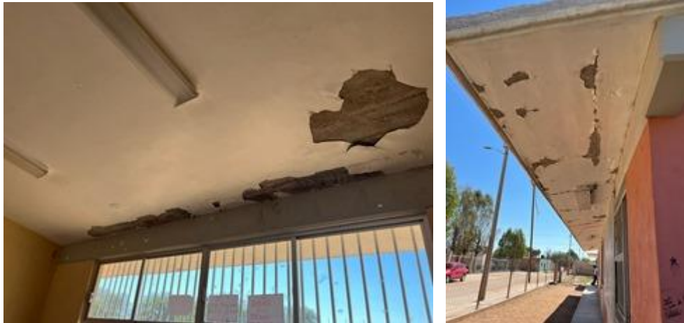
Imagen 10. Condición del plafón del aula 3
