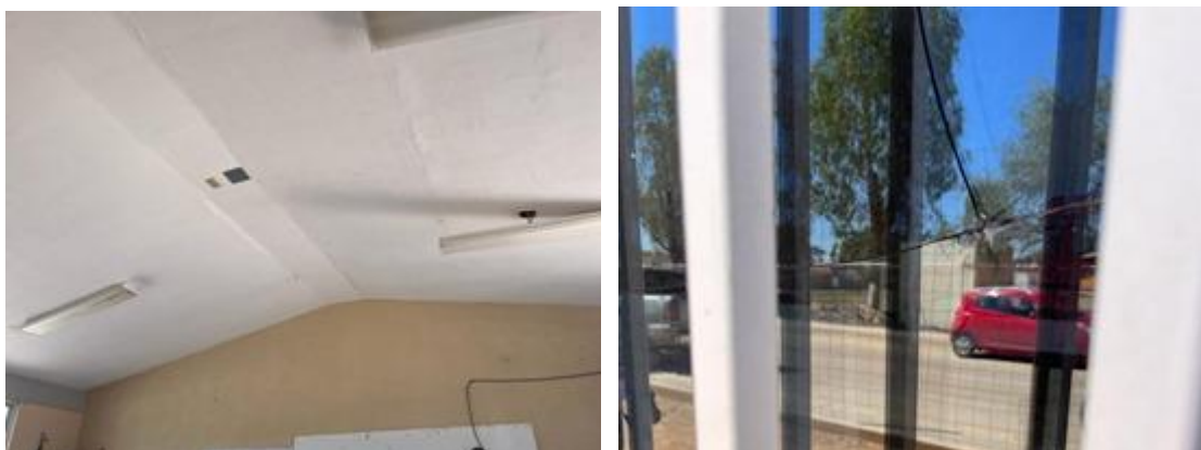
Imagen 9. Condiciones de las aulas de TBC
